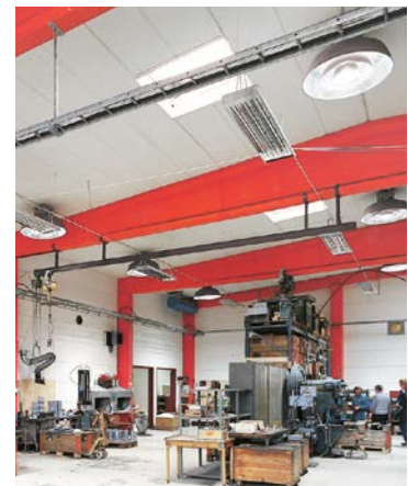
Mit IR-Wärmestrahlern kann die Temperatur in unterschiedlichen Raumbereichen perfekt angepasst werden. Punktuelltes Heizen erhöht den Komfort und verringert die Heizkosten.
